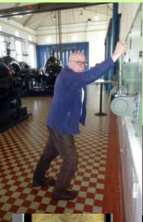
Heinz durfte das Schütz für die Motoren umlegen, die einen gewaltigen Lärm verursachten. Da die Rasterung des Hebels defekt war, musste er ihn die ganze Zeit halten. Das kostete ganz schön Kraft! Eckhard und Frank saßen hier vor dem kleineren Motor des Pumpenantriebes. Je nach Leistungsbedarf konnte bei laufendem Betrieb der kleine oder der große Motor gekuppelt werden.
